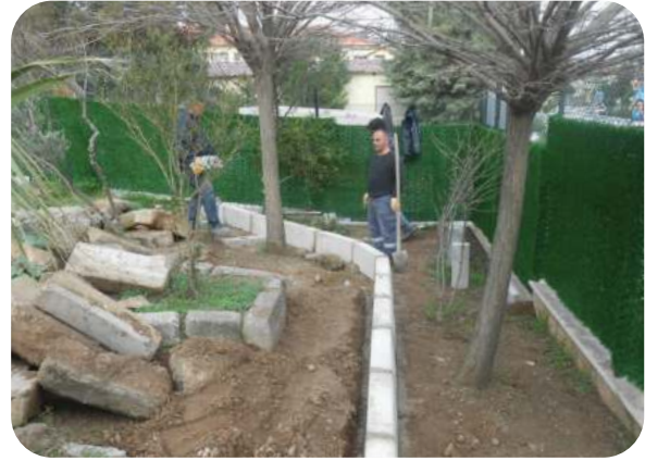
Nevvar Salih İşgören Anadolu Lisesi Okul Bahçesi Yeşil Alan Yürüyüş Yolu Ve Oturma Alanı Yapılması
