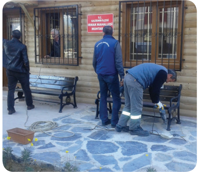
Irmak Mah. Muhtarlık Çevresi Toprak Tesviyesi, Bitki Dikimi ve Kent Mobilyası Montajı Yapımı
