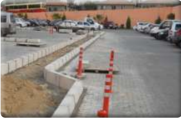
Sevgi Mahallesi Gazemir Nevvar Salih İşören devlet hastanesi otopark alanı ve orta refüj çalışması
