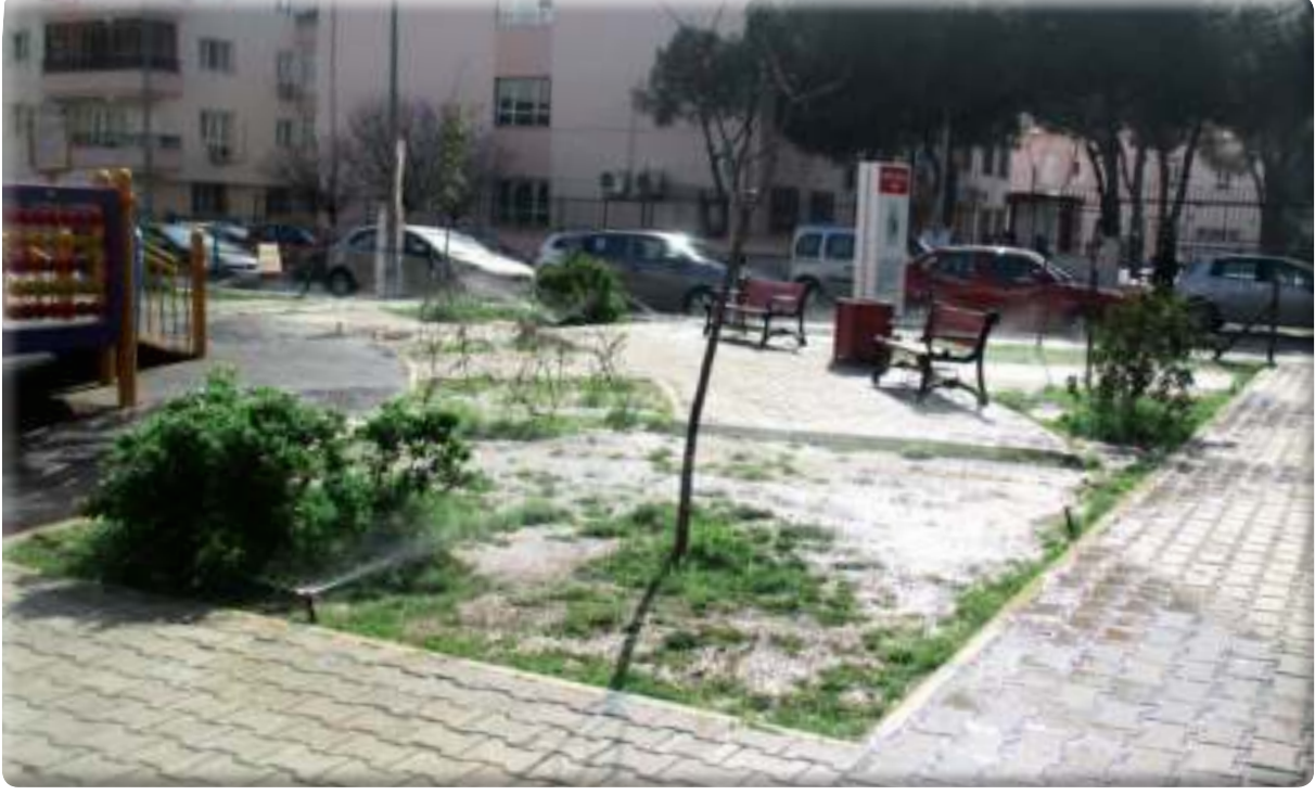
Mehmet Afacan Parkı ve Sevgi Yolu 2. Etapta, Kanal Gazimir 1.Etaba sulama sistemi döşenmiştir. Mevcuttaki 82 adet sulama sistemi bulunan parklarda bakım ve onarım yapılmıştır.
